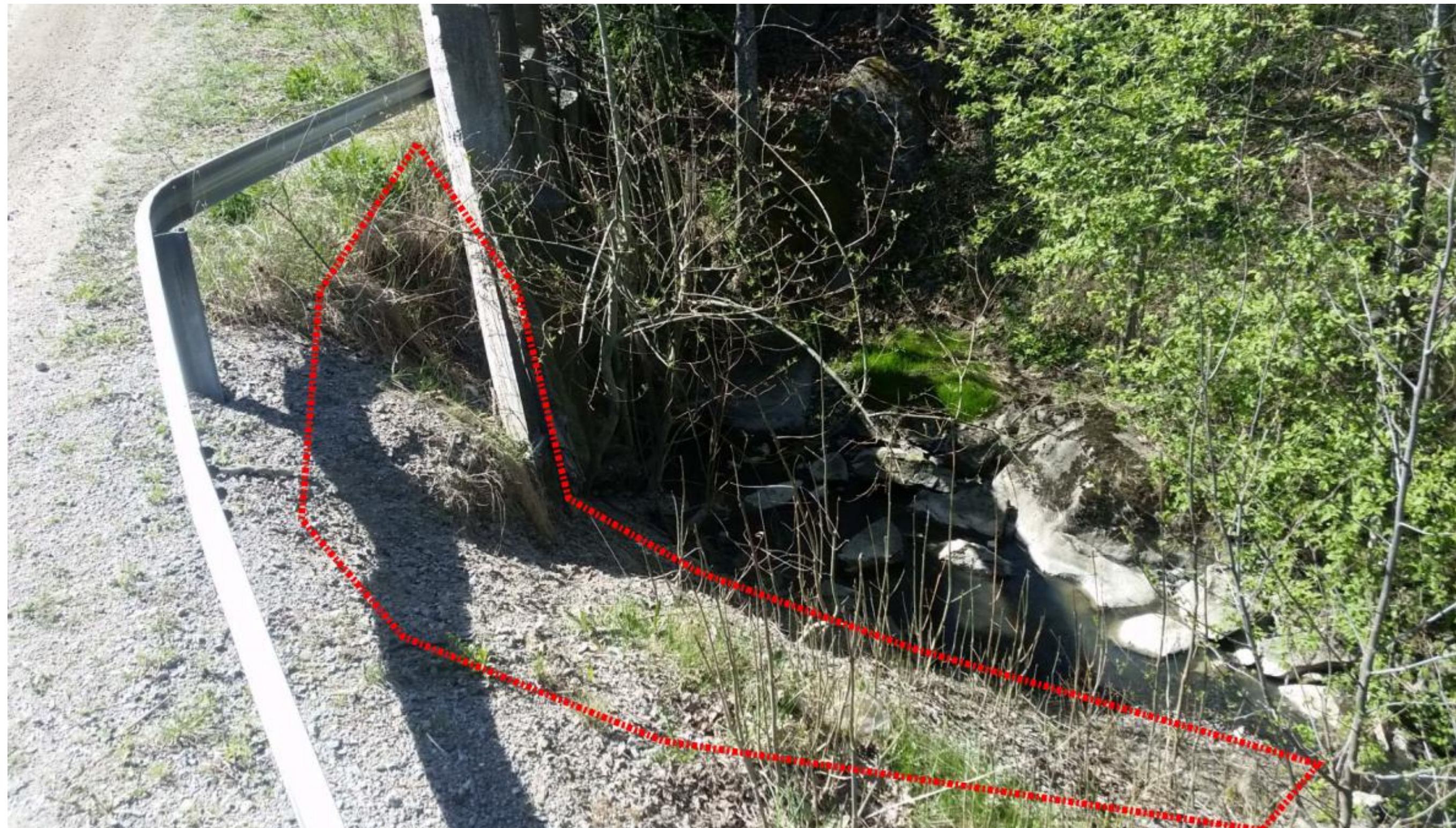
Figur 3. Ravin Gamla Norrbyvägen med riskområde för ras och erosion. Bilden är tagen i vy mot väster.
