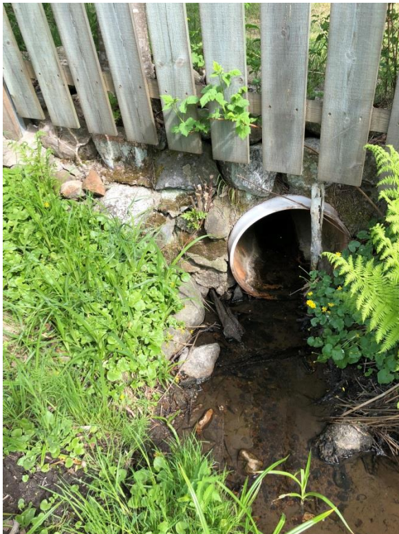
Figur 10 Dagvattentrumma med uppskattad dimension av 300 mm i rördiameter som mynnar ut i Vadviken. Bild från platsbesök 2018-05-21.
