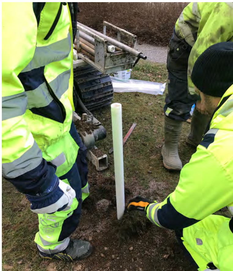
Figur 7. Söderbymalm. Grundvattenrör på gräsmattan i anslutning till borrhål 5.
